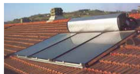
Impianto solare termico
